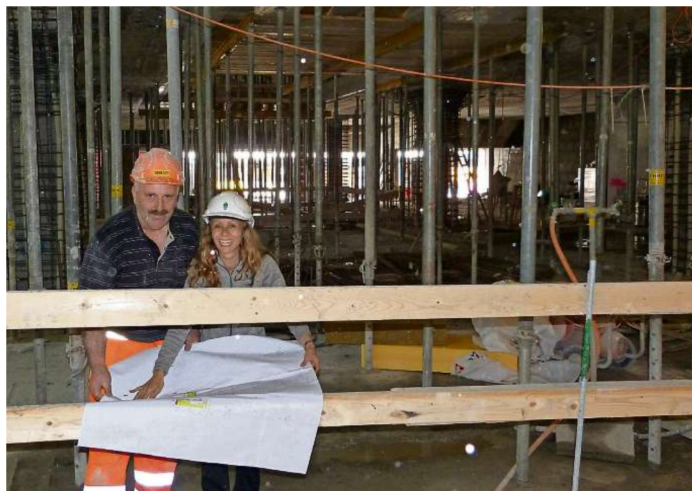
Im Stützenwald, der das Erdgeschoss im Moment noch auszeichnet, bespricht Chef-Bauleiterin Jeannette Wehrli mit Polier Rami Sulymani die Pläne.
